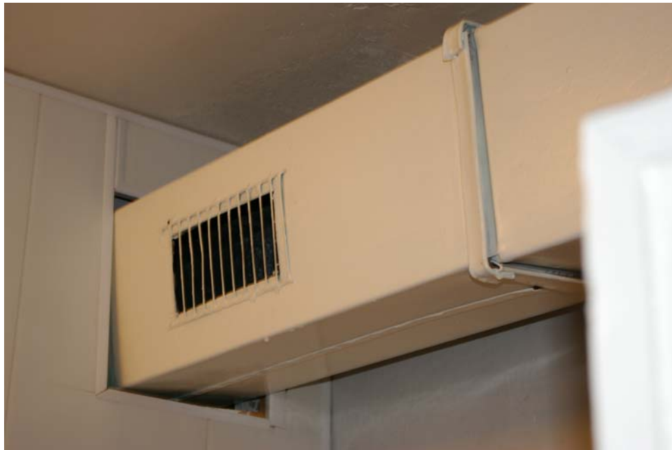
Фото 6 Канал обеспечивающий одновременно (!) удаление воздуха из вытяжного шкафа и вентиляцию помещения
