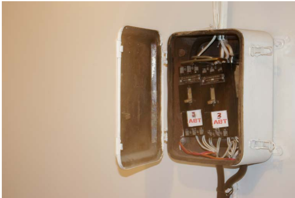
Фото 4 Пример подключения оборудования
