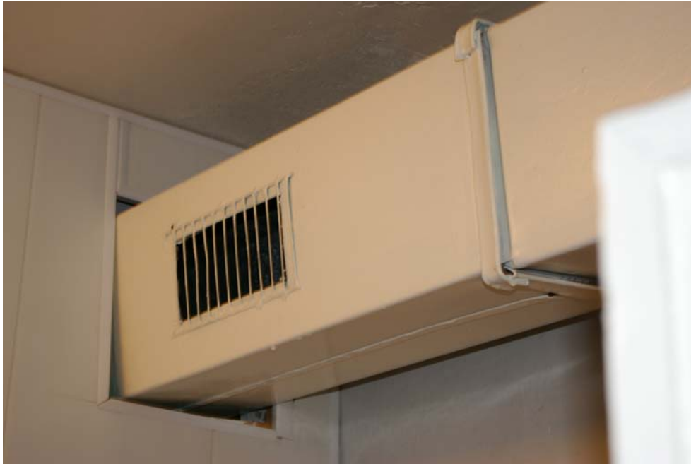
Photo 6 Gaine assurant simultanément (!) l'extraction d'une Sorbonne et la ventilation de la pièce
